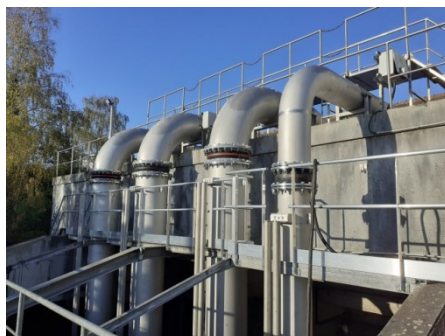
Conduite de refoulement
