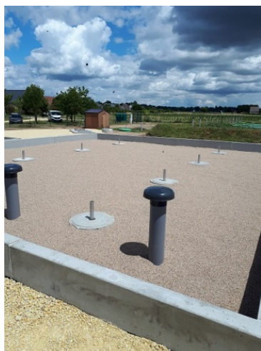
les lits filtrants avant plantation des roseaux
